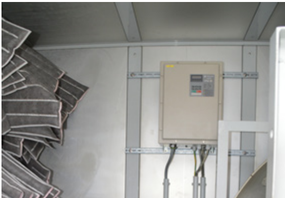
Der neue Antrieb ist deutlich kleiner und leichter als der alte. An der Wand wurde der kompakte Frequenzumrichter montiert.
